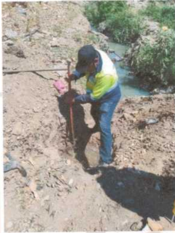
SE DESTAPO EL TAPON QUE ESTABA EN LA TUBERÍA PRINCIPAL
