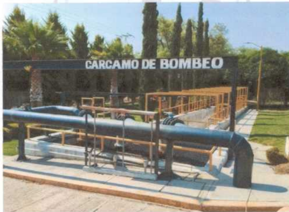
SE MANTUVO LIMPIO EL CARCAMO DE BOMBEO
