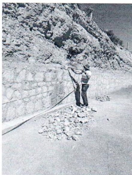
Levantamiento de deslave de piedras de muro perimetral
